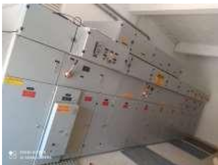
Casa de Máquinas
