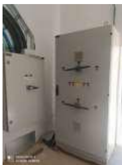
Casa de Máquinas
